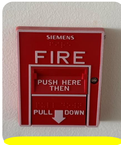
جهاز إنذار الحريق
